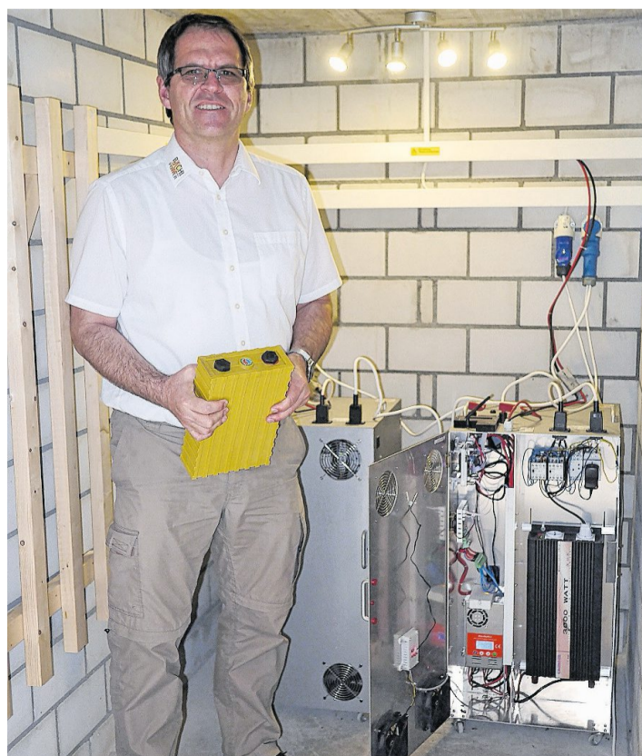
Daniel Bächli beim Herzstück der Anlage: In den zwei Powerboxen wird die Energie gespeichert.
